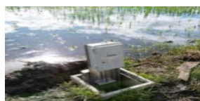
IoT水門の設置
